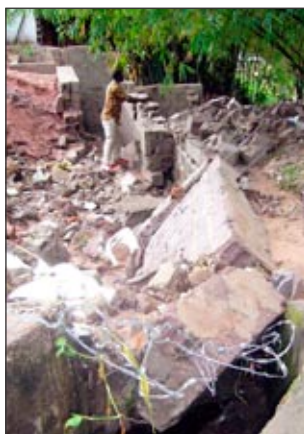
Un des murs écroulé de notre voisin.
