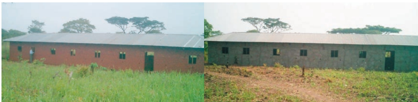
Vlevo: stěny zdravotního střediska dosahují až ke střeše. Vpravo: cementová omítka na ochranu proti dešti.
